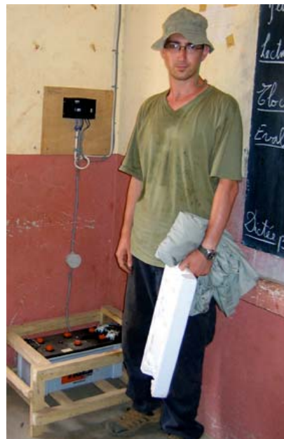
Tom Burrell, fieldkoordinator for Danida-projektet hos Mali-Folkecenter i Bamako ved lade-regulatoren og batterier på skolen i Koualé
